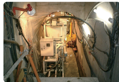
監査廊内の設置状況
