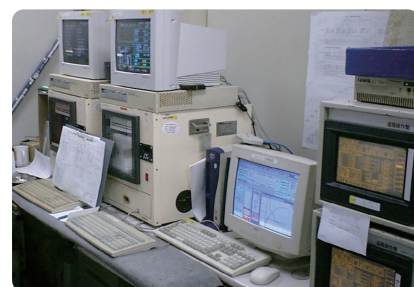
管理室 操作盤
