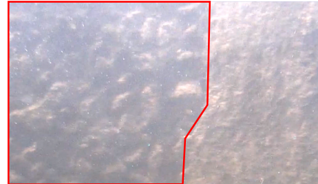
写真-4 導水路側壁摩耗状況(大鳥居)
