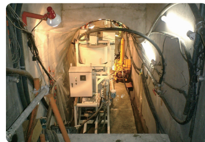
監査廊内の設置状況
