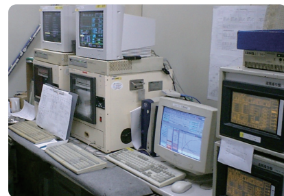
管理室 操作盤
