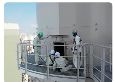
煙突外部劣化診断
