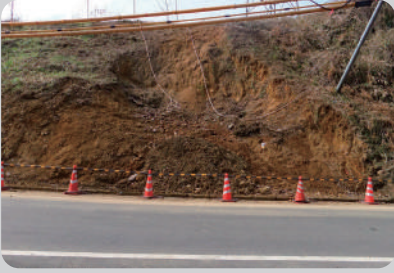
1 表層崩壊した斜面
